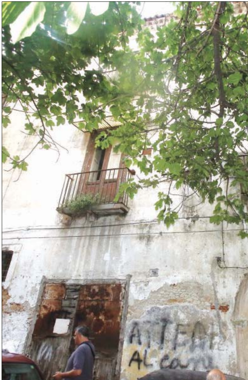
Il palazzo interessato dal crollo del solaio
